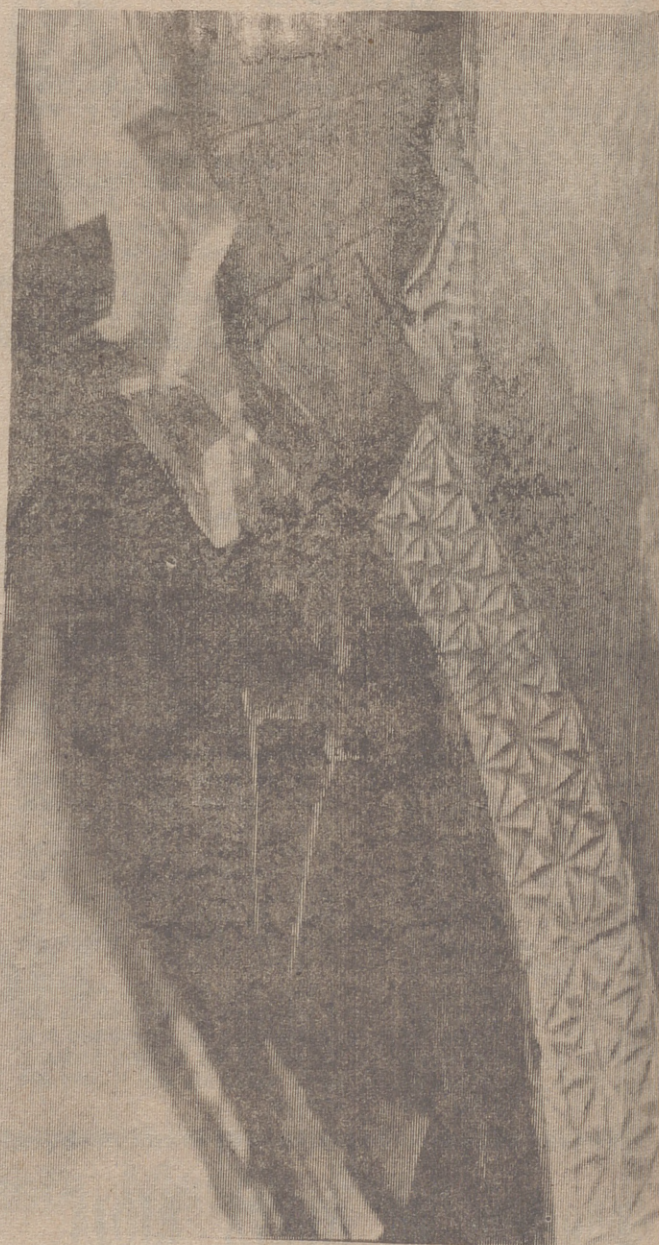
Detalle de la puerta Oeste, cuyo acceso está impedido por el edificio de las escuelas y de dos viviendas, privando así que el visitante pueda ver esta fachada.
