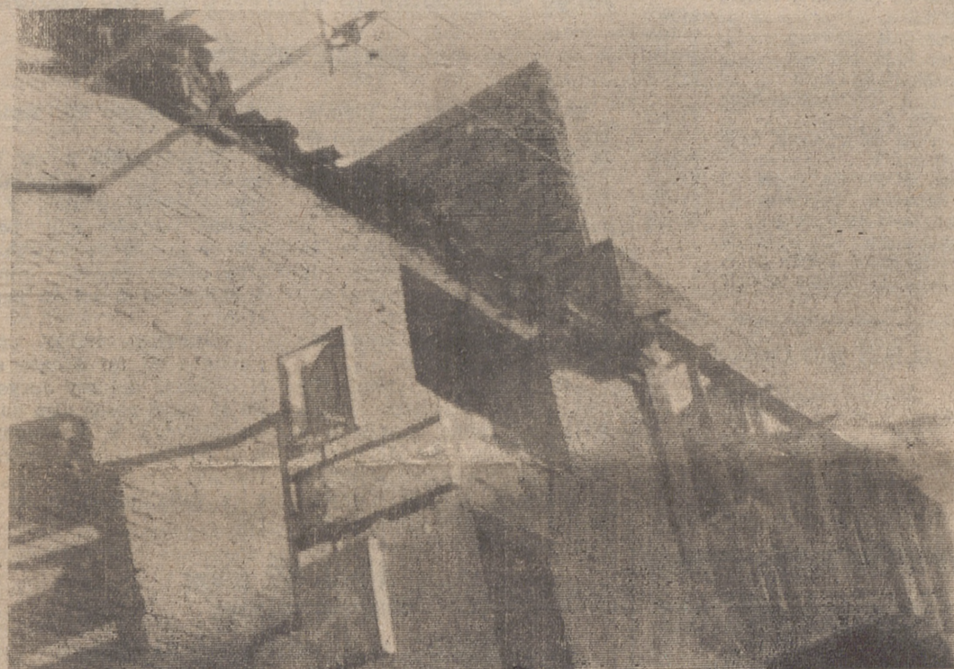
Cornisa desplomada. — (Foto Sánchez)
