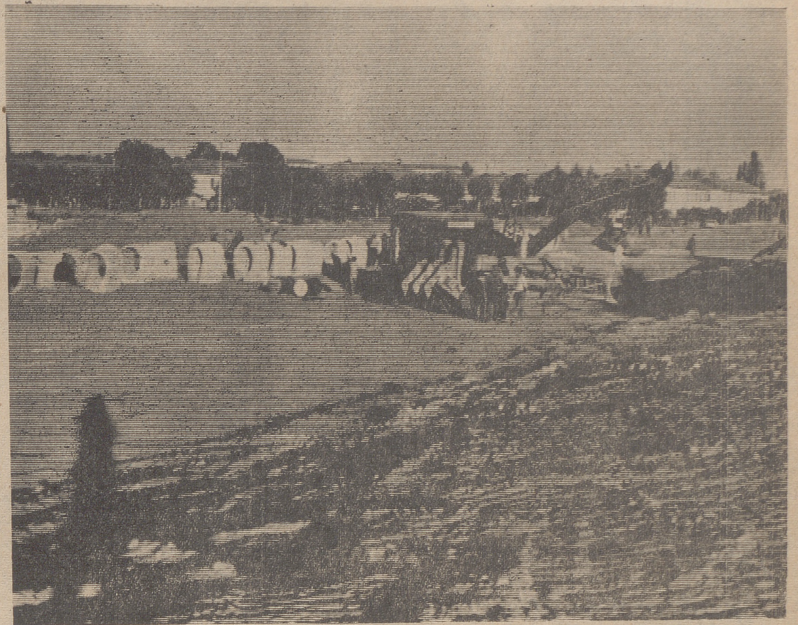
El polígono de Lobete todavía será por mucho tiempo noticia. Aquí tenemos una vista parcial de las obras de pavimentación. La posible ubicación en sus solares de mil viviendas a construir por la Caja de Ahorros de Zaragoza vuelve a la actualidad más rabiosa este discutido trozo de la geografía logroñesa. — (Foto «Payá»).
