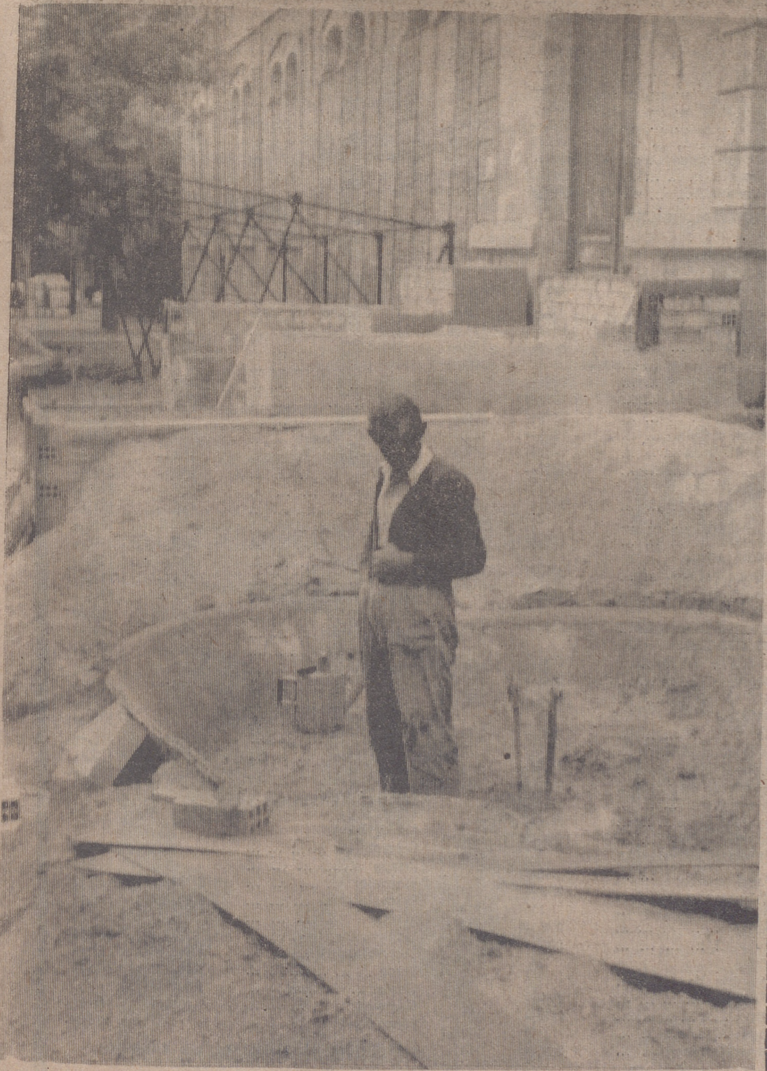
Nuestra ciudad empieza a desprender un olorillo de fiestas. A ritmo de vértigo se han iniciado los preparativos. Los albañiles han entrado con sus tenderetes para colocar las casetas y puestos de la Feria de la Flor y de la Planta. Ahora comenzarán a instalarlos con urgencia fabulosa y el recinto, en unos breves días, para goce y felicidad de todos, cobrará una brillante y efímera vida. La Feria de la Flor y de la Planta ha adquirido ya su mayoría de edad. — (Foto HERCE).
