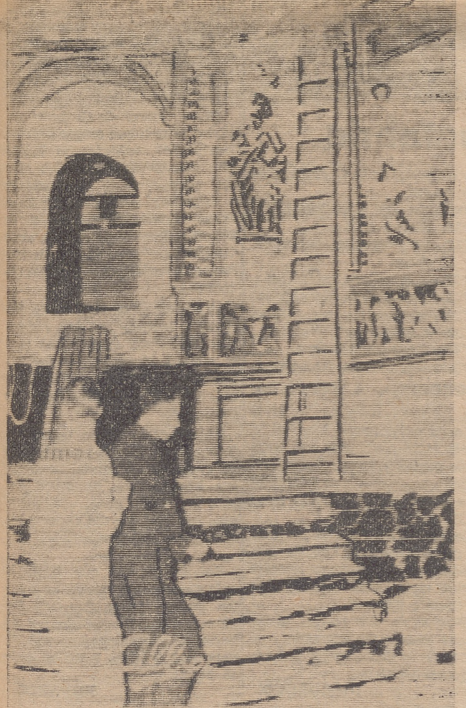
La iglesia de Santiago el Real está en obras. El presbiterio se halla completamente derribado. En la foto vemos un aspecto del altar mayor en el que se puede apreciar una escalera y una cuerda que los obreros utilizan para su trabajo de reconstrucción.
